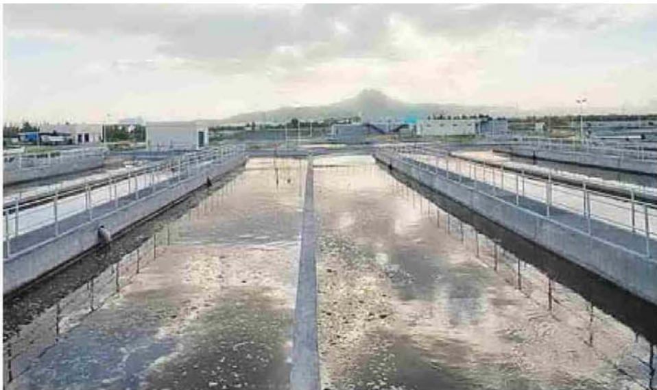
La compañía se ha especializado en plantas potabilizadoras y de tratamiento. JOSE RODRÍGUEZ
